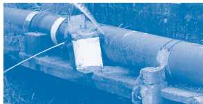
Flagrante de ligações clandestinas em adutora
