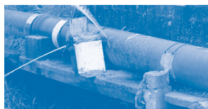
Flagrante de ligações clandestinas em adutora
