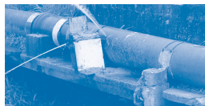
Flagrante de ligações clandestinas em adutora
