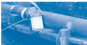
Flagrante de ligações clandestinas em adutora
