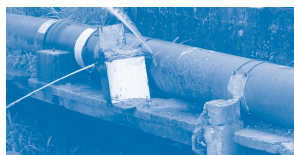
Flagrante de ligações clandestinas em adutora
