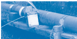
Flagrante de ligações clandestinas em adutora
