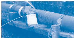
Flagrante de ligações clandestinas em adutora
