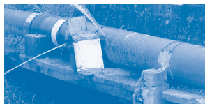
Flagrante de ligações clandestinas em adutora
