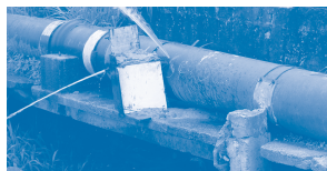
Flagrante de ligações clandestinas em adutora
