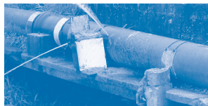
Flagrante de ligações clandestinas em adutora
