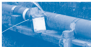
Flagrante de ligações clandestinas em adutora
