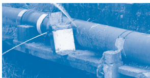
Flagrante de ligações clandestinas em adutora
