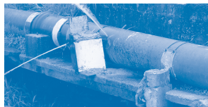
Flagrante de ligações clandestinas em adutora
