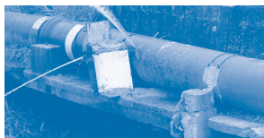
Flagrante de ligações clandestinas em adutora
