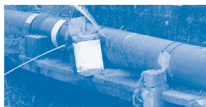
Flagrante de ligações clandestinas em adutora
