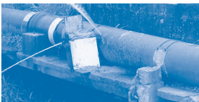
Flagrante de ligações clandestinas em adutora
