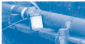
Fragmento de ligações clandestinas em adutora Evite e denuncie o "gato", ele poderá levar doença para dentro de sua casa.
