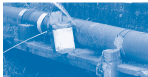
Flagrante de ligações clandestinas em adutora
