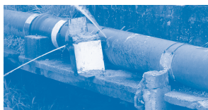
Flagrante de ligações clandestinas em adutora Evite e denuncie o "gato", ele poderá levar doença para dentro de sua casa.
