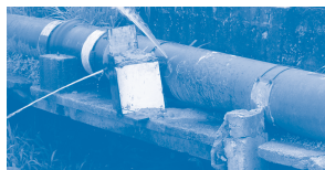
Flagrante de ligações clandestinas em adutora
