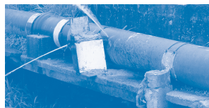
Flagrante de ligações clandestinas em adutora
