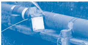
Flagrante de ligações clandestinas em adutora
