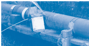
Flagrante de ligações clandestinas em adutora
