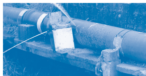
Flagrante de ligações clandestinas em adutora
