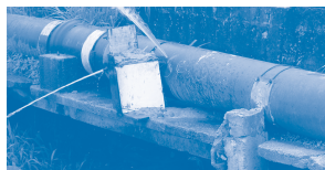
Flagrante de ligações clandestinas em adutora
