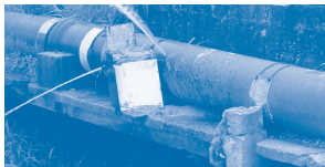
Flagrante de ligações clandestinas em adutora
