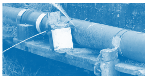
Flagrante de ligações clandestinas em adutora
