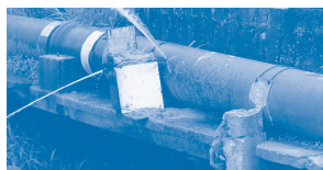
Flagrante de ligações clandestinas em adutora
