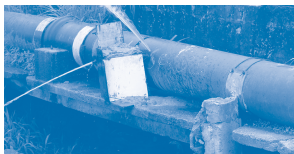
Flagrante de ligações clandestinas em adutora
