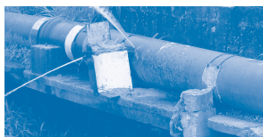
Flagrante de ligações clandestinas em adutora
