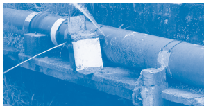
Flagrante de ligações clandestinas em adutora
