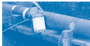
Flagrante de ligações clandestinas em adutora
