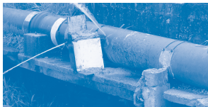
Flagrante de ligações clandestinas em adutora
