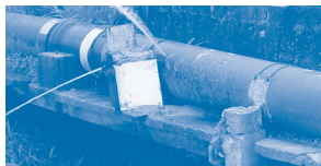
Flagrante de ligações clandestinas em adutora
