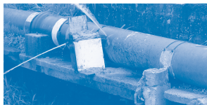
Flagrante de ligações clandestinas em adutora
