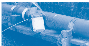
Flagrante de ligações clandestinas em adutora
