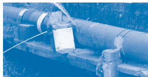
Flagrante de ligações clandestinas em adutora Evite e denuncie o "igato", ele poderá levar doença para dentro de sua casa.
