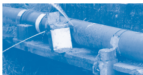
Flagrante de ligações clandestinas em adutora
