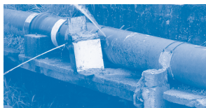
Flagrante de ligações clandestinas em adutora
