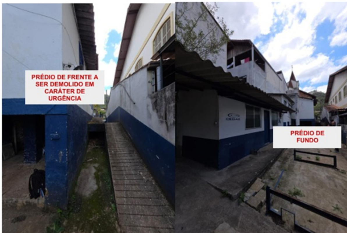
FIGURAS 9 E 10 – PRÉDIO DA FRENTE E PRÉDIOS DA FRENTE E DO FUNDO RESPECTIVAMENTE
