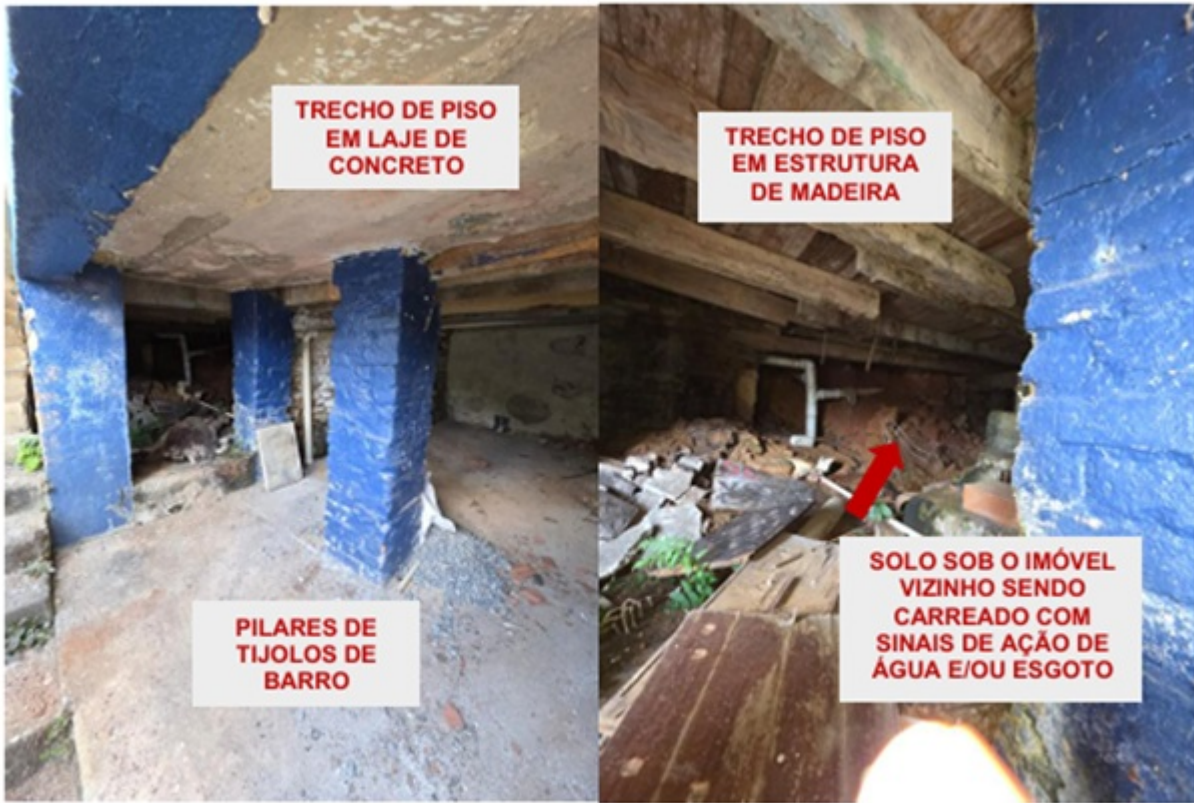
FIGURA 2 e 3 – FUNDO DO PRÉDIO DA FRENTE EM RUÍNA
