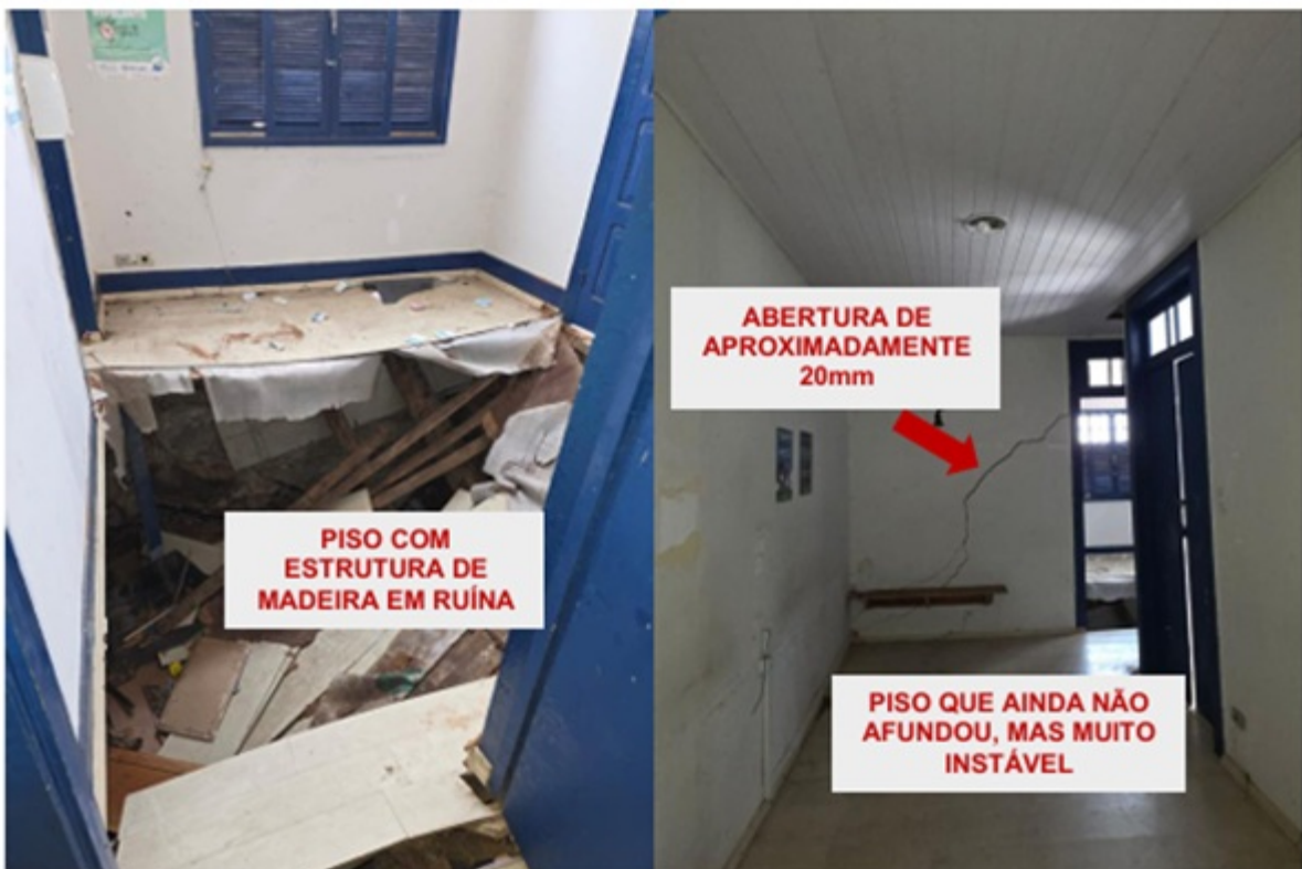
FIGURAS 4 e 5 – PISO EM RUÍNA E FENDA NA ALVENARIA
