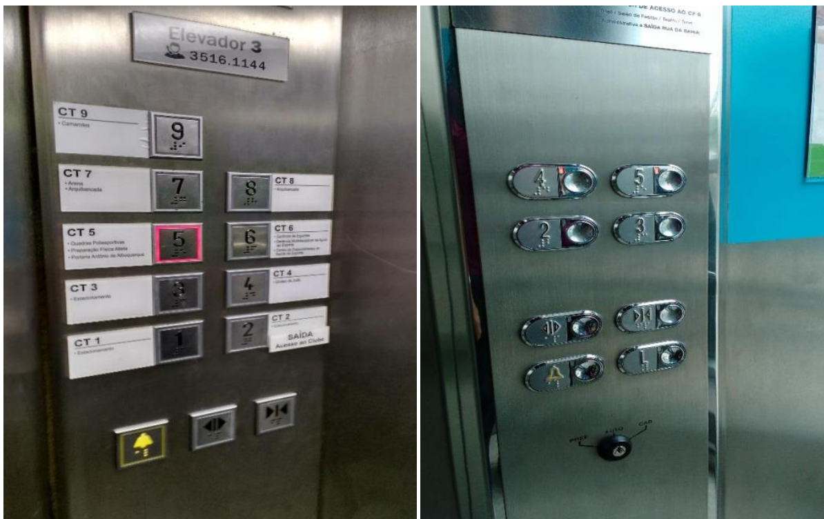
Sinalização tátil elevadores.
