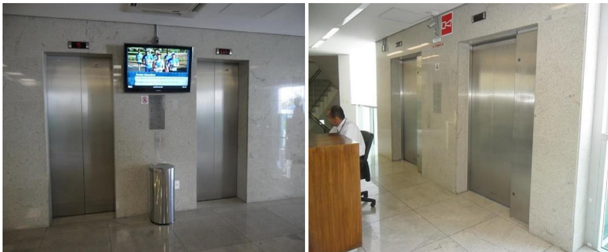
Elevadores de acesso ao Clube.
