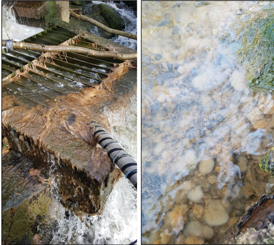
Figur 3.12. Bølerbekken er påvirket av organisk belastning. Bildet er tatt 28.03 2018, oppstrøms teststrekningen for formiat.
