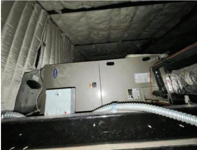
19 - FAN COIL UNIT
