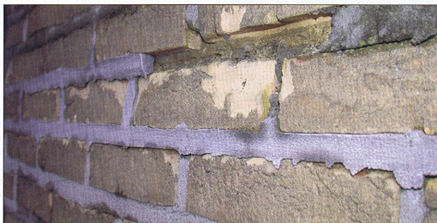
Vorstschade aan de stelmortel (gele kleur) en uitstoten van de voegen.
