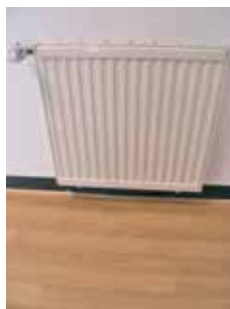
Moderner Heizkörper mit Thermostat-Ventil
