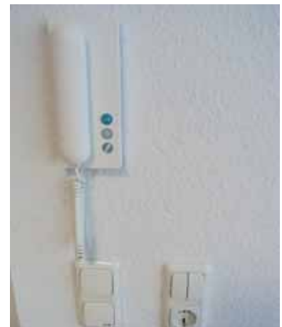
Gegensprechanlage, Lichtschalter und Steckdosen
