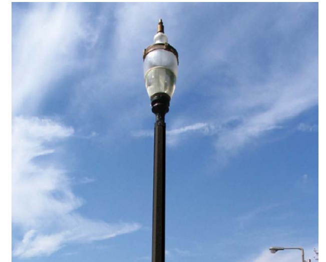
UMA CLIP SPECIFIED LIGHT FIXTURE (NON-COMPLIANT)
