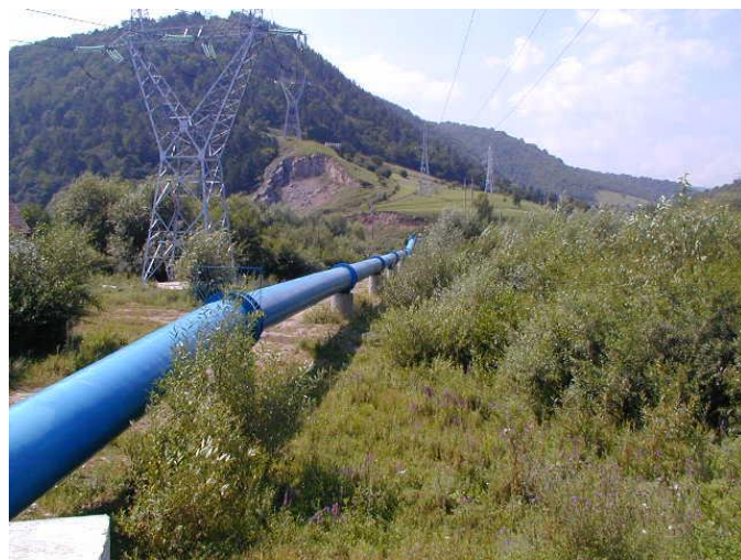
Aducțiunea Gilău – Stația de tratare reabilitată
