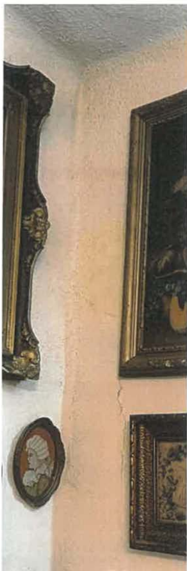
Foto 9 – Fisuri identificate in perete – living (07.01.2021)
