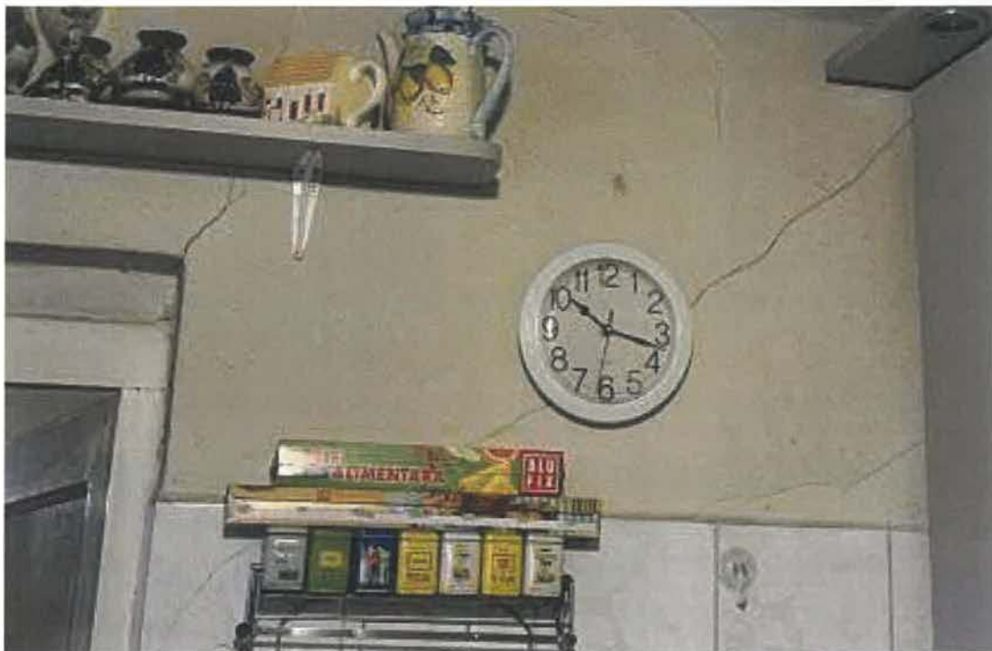
Foto 4 – Fisuri la 45° identificate in perete bucatarie (07.01.2021)
