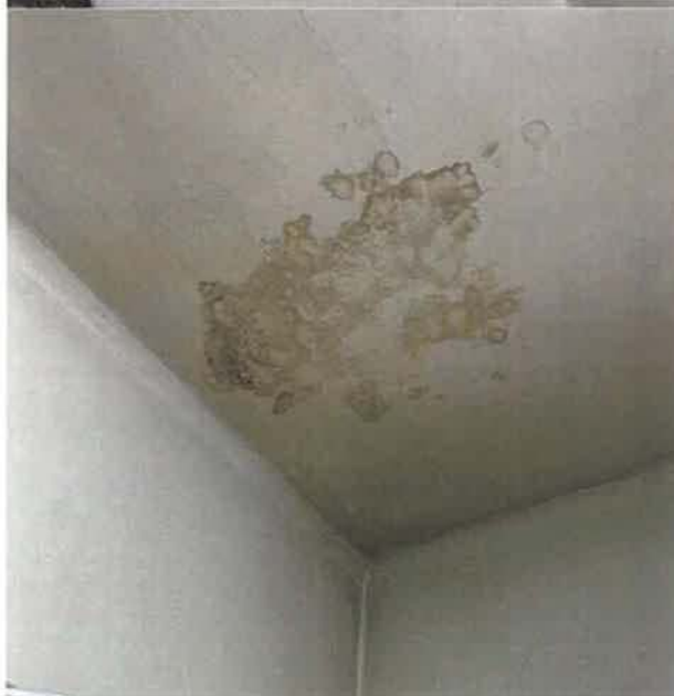
Foto 12 – Fisuri identificate pe pereti si intrados planseu – bucatarie (07.01.2021)
