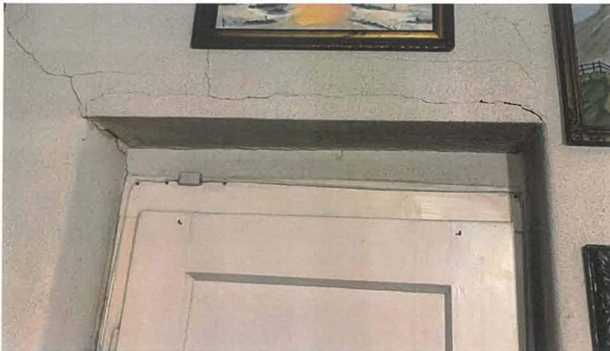
Foto 1 – Fisura in perete, identificata in zona buiandrugului – intrare bucatarie (07.01.2021)
