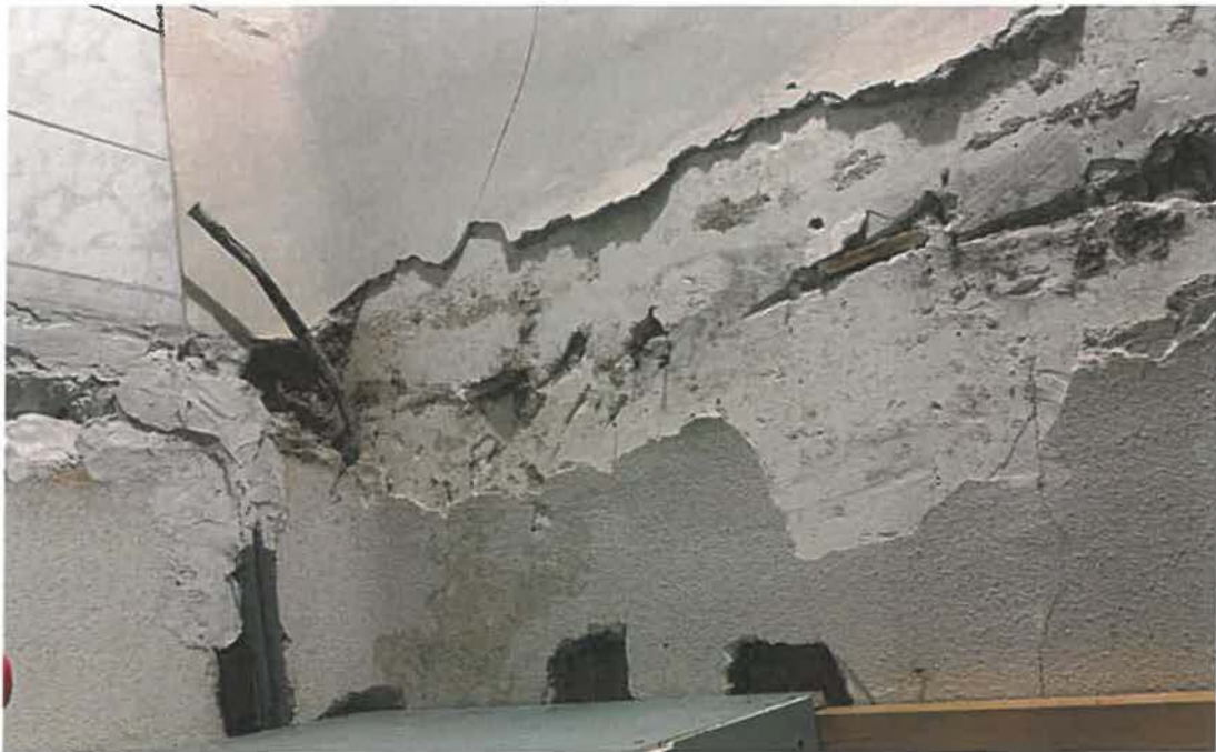
Foto 3 – Fisuri identificate in peretele si planseul bii (07.01.2021)
