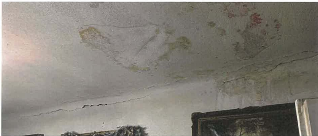
Foto 2 – Fisuri indetificate pe toata lungimea peretelui si intrados planseu (07.01.2021)
