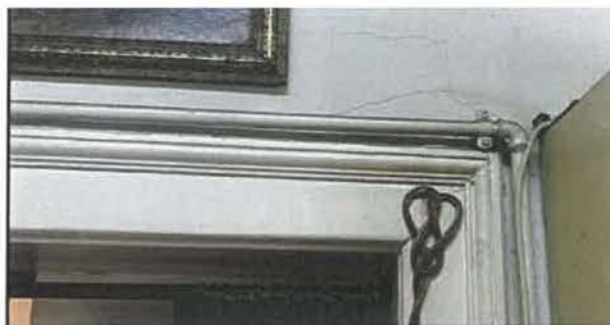
Foto 10 – Fisuri identificate in buiandrug – usa bucatarie (07.01.2021)
