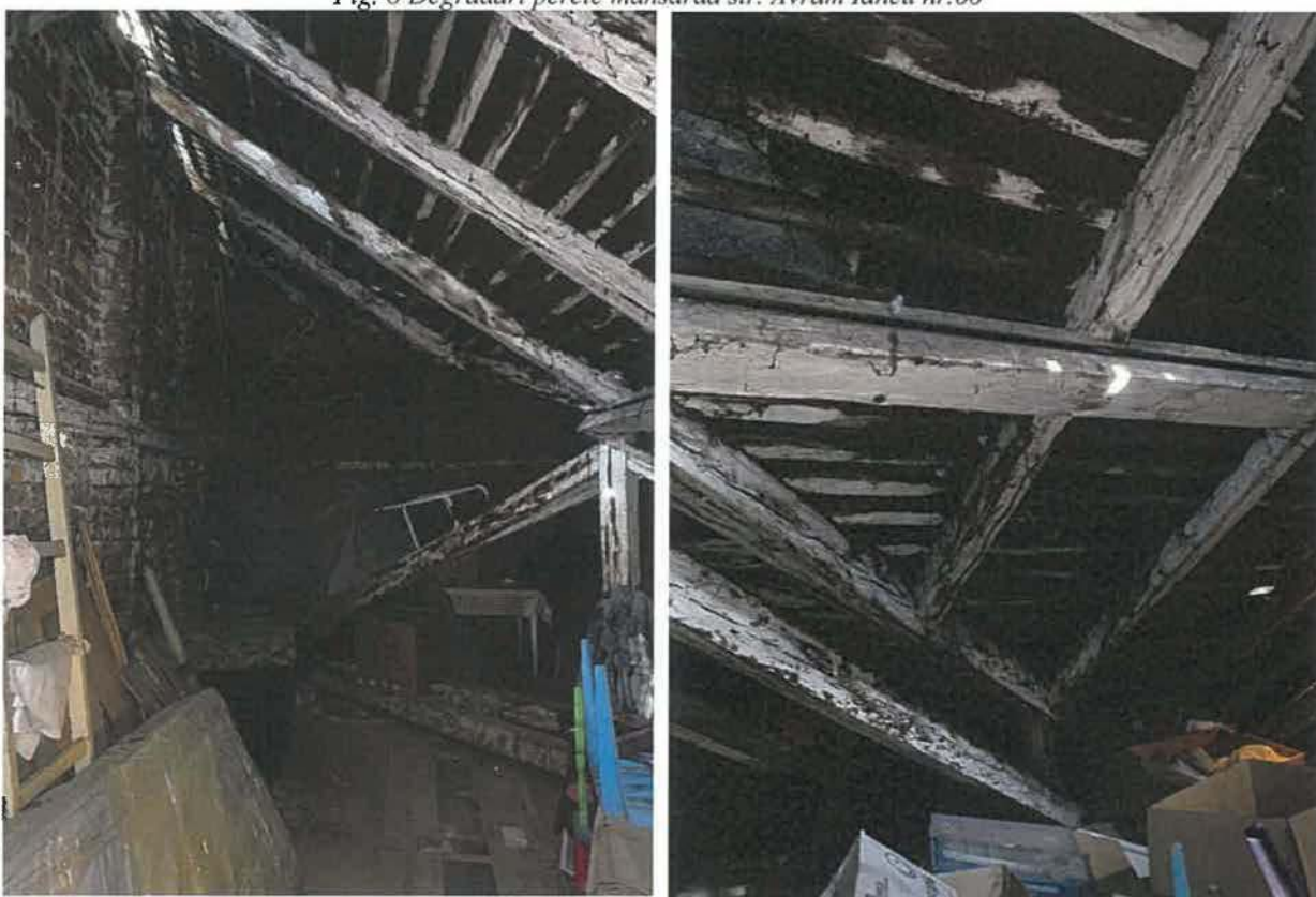
Fig. 9 Degradări șarpantă str. Avram Iancu nr.66
