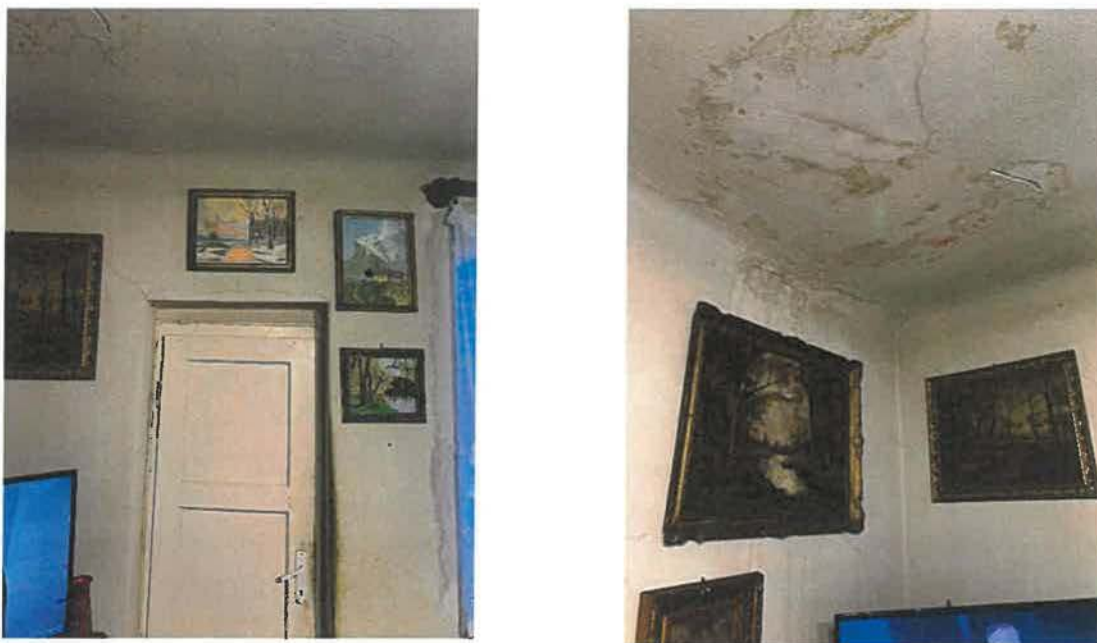
Fig. 4 Fisuri indentificate în construcția de pe str. Aviator Bădescu nr. 1B
