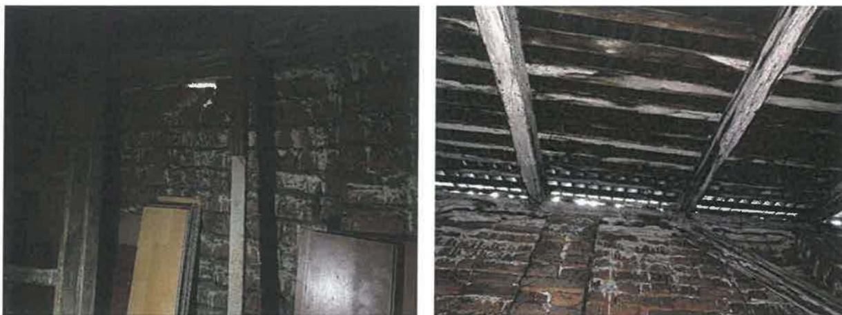
Fig. 8 Degradări perete mansardă str. Avram Iancu nr.66
