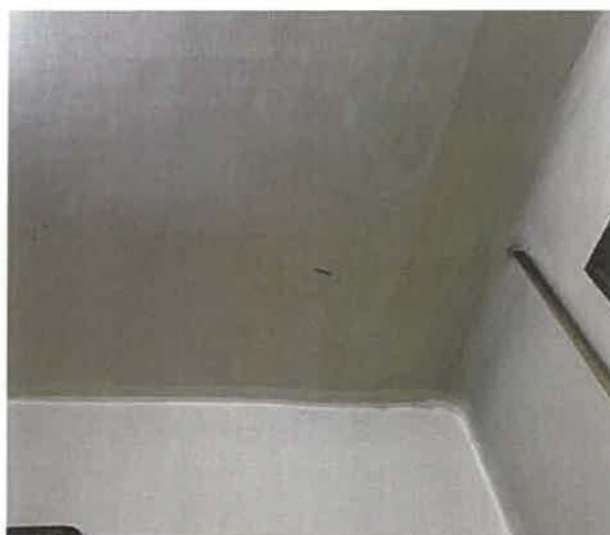
Foto 11 – Fisuri identificate in intrados planseu bucatarie (07.01.2021)
