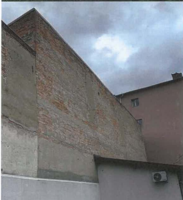
Foto 24 - Calcan comun – strada Avram Iancu nr. 70-72 (07.01.2021)
