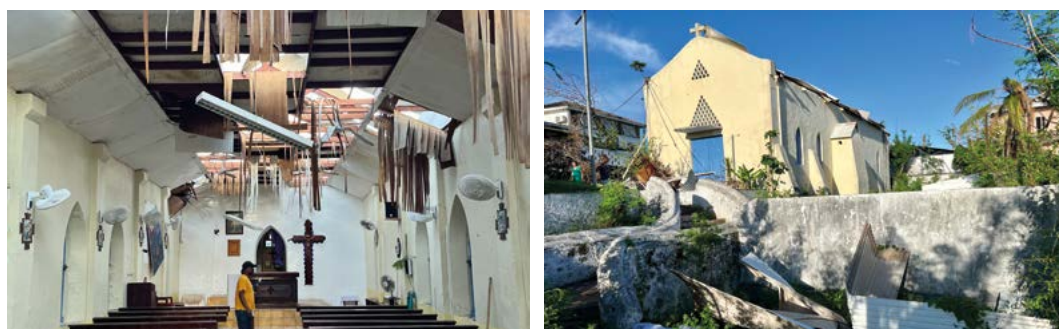
Chapelle Saint-Michel après le passage du cyclone Chido © Fondation du patrimoine
