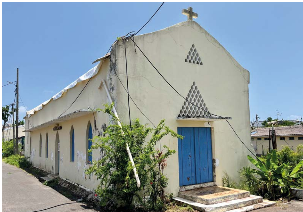
Chapelle Saint-Michel après le passage du cyclone Chido © Fondation du patrimoine
