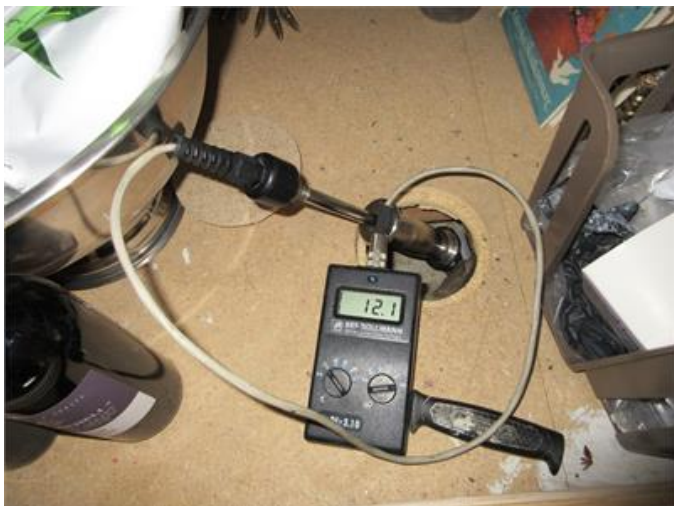
Fuktmätning i uppreglat golv i trappförråd
